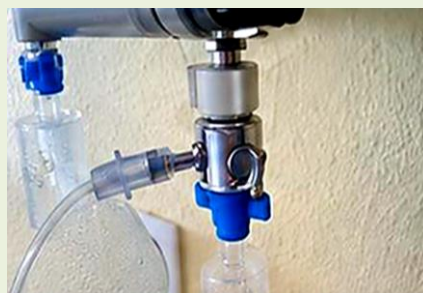
Toma de aire comprimido
